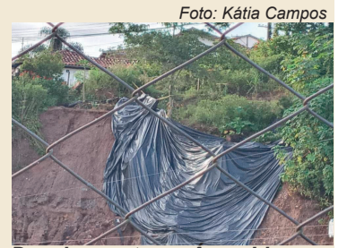
Desabamento no Água Limpa
